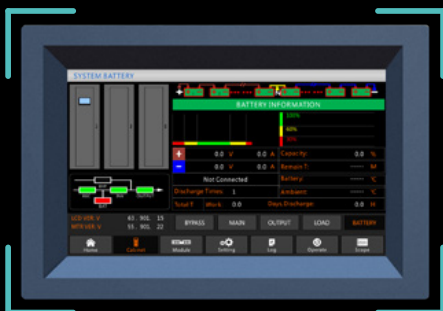
Écran d'information sur l'état des batteries.
