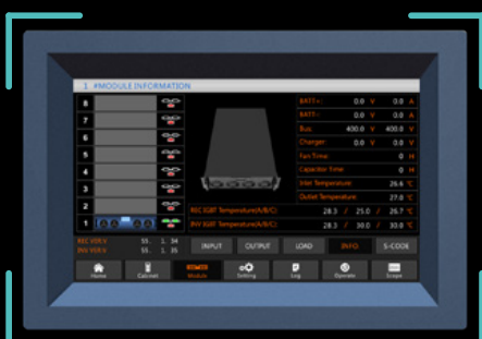
Écran d'informations sur l'état des modules de puissance.
