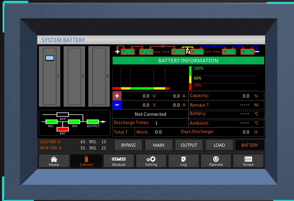
Écran d'information sur l'état des batteries
